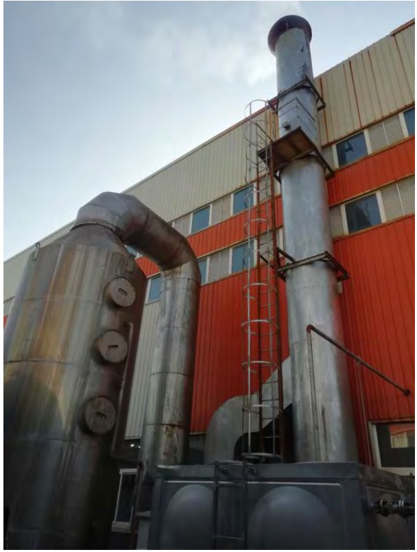
煅烧酸雾吸收塔
